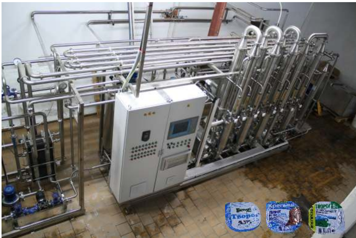
Установка марки «ВОДОПАД МТК 36,15-4-138», 500 кг творога в час; г. Саратов, ООО «Комбинат детского питания»; эксплуатируется с 2010 г.
