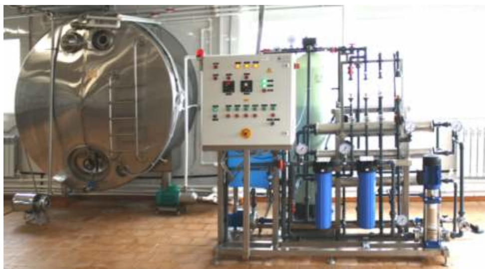
Установка марки "ВОДОПАД МЖ 1,0-1-3,95-40-3", 1000 л/ч подготовленной воды для мойки мембранной установки; ЗАО "Сернурский сырзавод"; эксплуатируется с 2015г.
